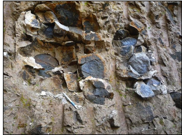
Foto 47: Alterações esferoidais dos basaltos na base da saibreira.
