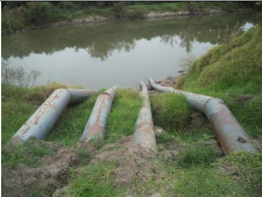
Figura 6.2-81 Adutoras de captação de água do rio Quaraí para as lavouras de arroz.
